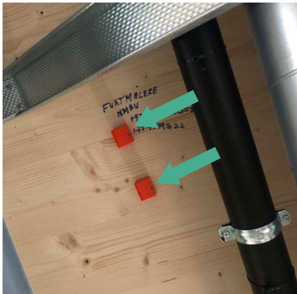
Figur 4. Sensorer for måling av temperatur og relativ luftfuktighet plassert i taket på fellesarealet, to sensorer er markert med grønn på pil. Bilde: Trebruk AS.
