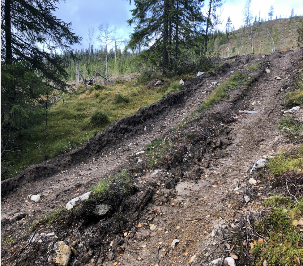
Basveg i hellende terreng der faren for erosjon er stor i nedbørrike perioder. Foto: Trygve Øvergård.
