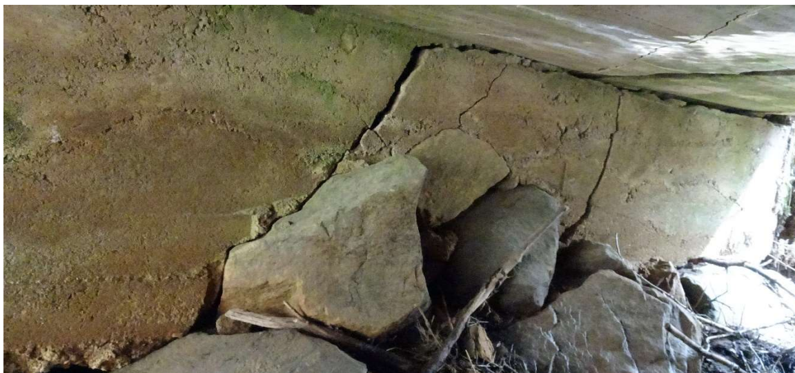
Bilde 14: Undergraving og oppsprekking av både brufundament/landkar og oppsprekking av betongplate.
