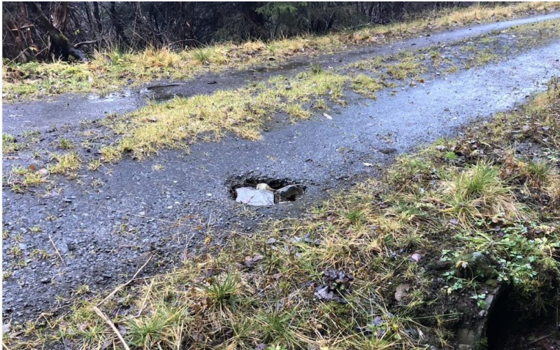
Bilde 20: Typisk punkt der en stikkrenne må registreres for utskifting
